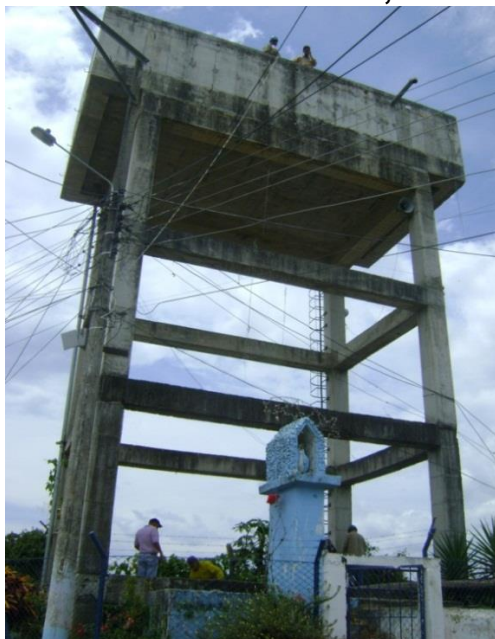
Figura 3. Tanque de almacenamiento El Pablón, ubicado en el sector alto.
