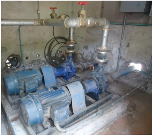
Figura 17. Sistema de bombeo
