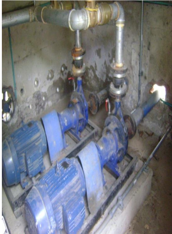
Figura 4. Motobombas e instalación hidráulica de la estación de bombeo El Pablón.
