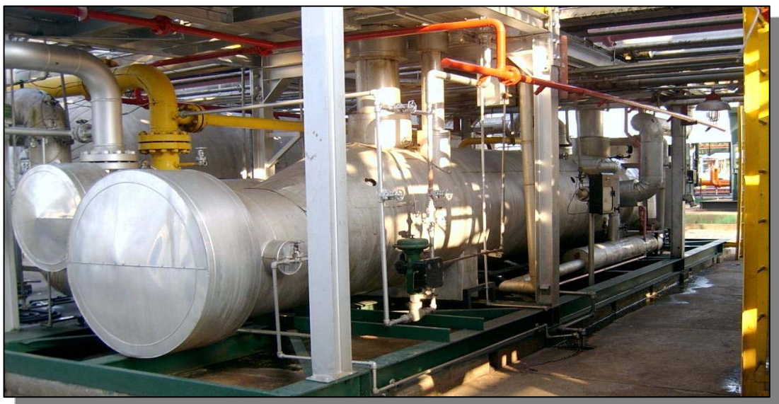
Figura 2.4: Refrigerador de Propano (Chiller)
