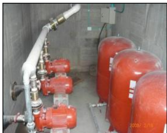
Figura. 4 Sistema de bombeo pradera.
