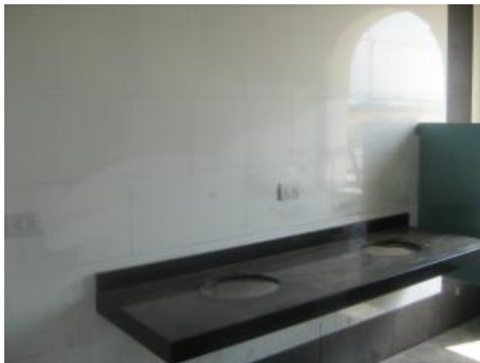
Figura. 37 Enchapes baños públicos.
