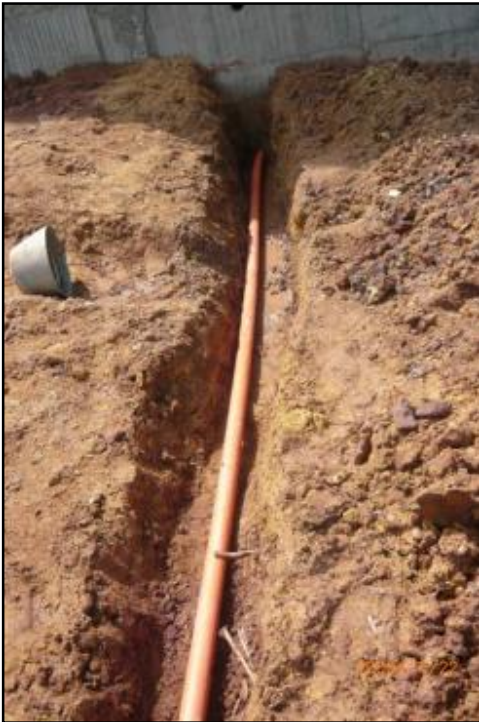
Figura. 75 Descole en tubería 2”.
