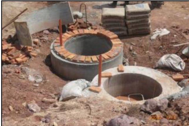
Figura. 15 Pozos de inspección: Pluvial y sanitario Náutica.
