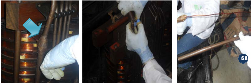
5. Recolección de papel que recubre cableado de fases (muestra 6A)
