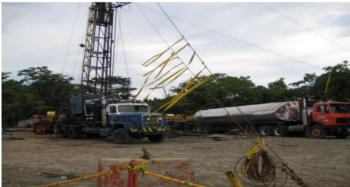
Ilustración 8. Unidad Cementadora Actual Operativa Propiedad de Ecopetrol - SOM
