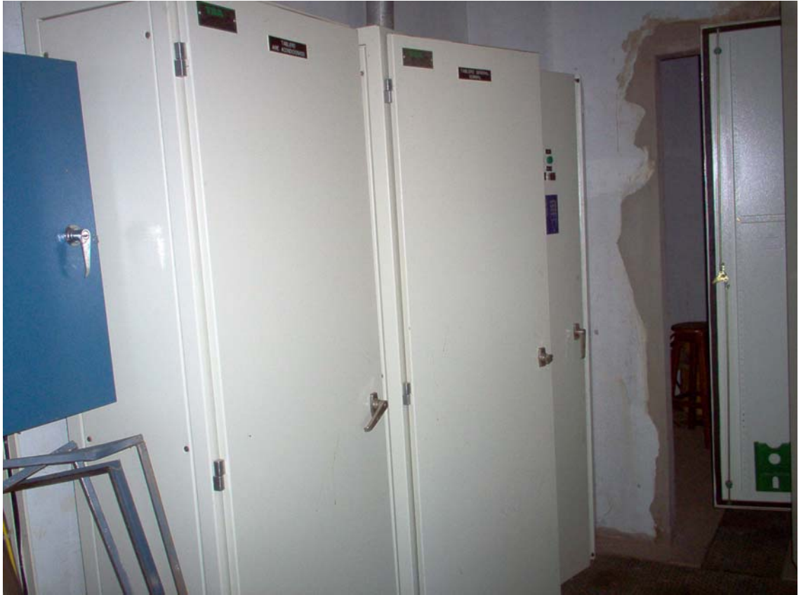
Anexo E TABLEROS DE DISTRIBUCION
