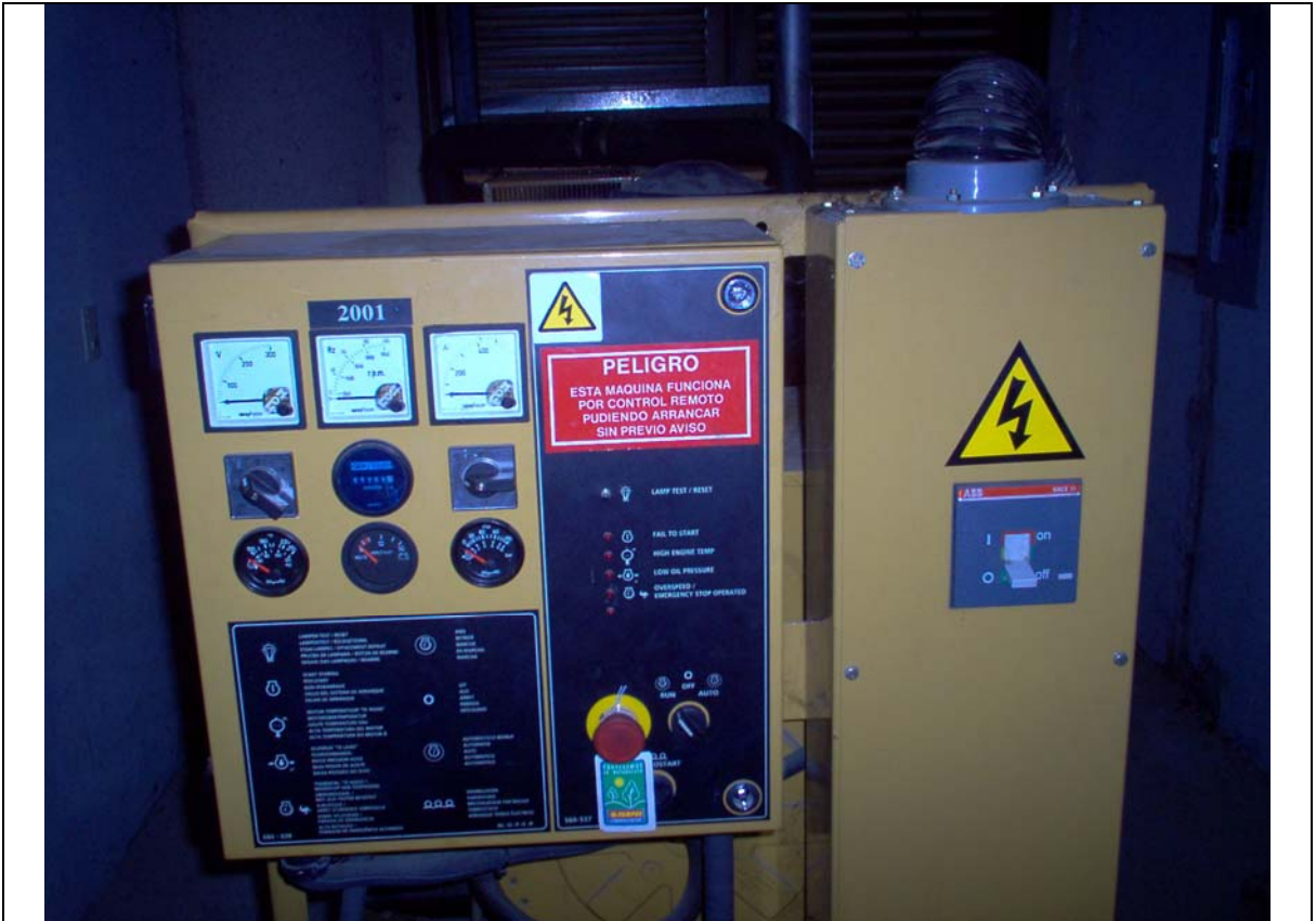
Anexo B TABLERO DE MANDO PLANTA ELECTRICA
