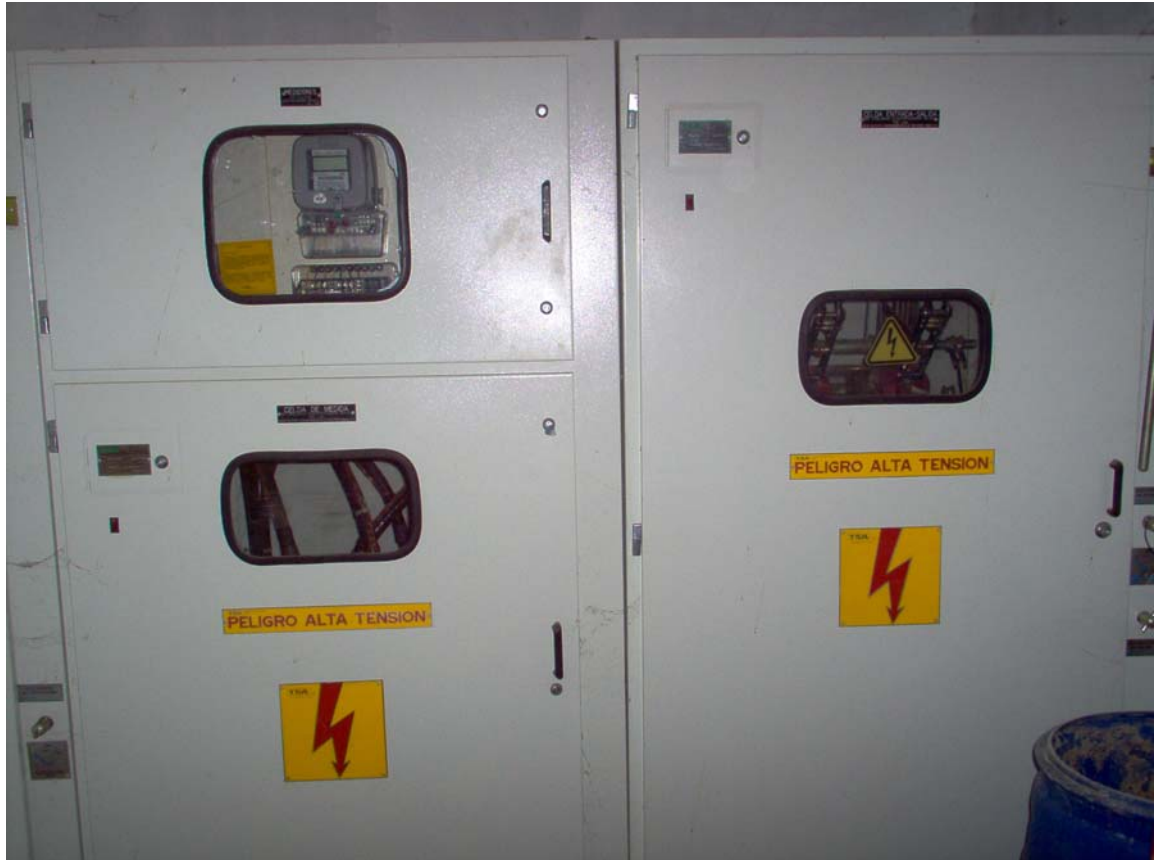
Anexo D EQUIPOS DE LA SUBESTACION
