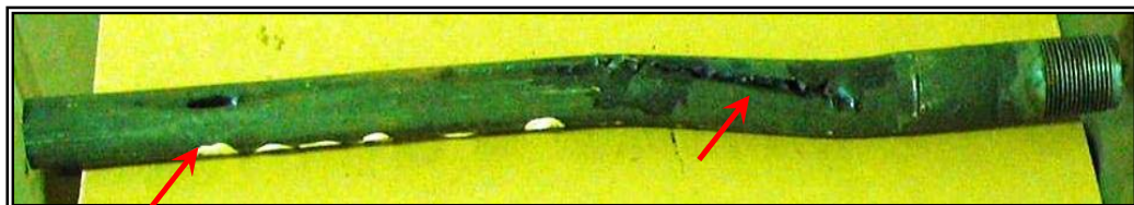
Figura C30. Tubo de tiro abollado por caída de presión y rozamiento
