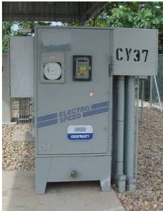
Figura 19. Variador de Frecuencia
