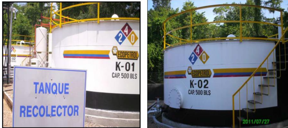
Figura 27. Tanques de almacenamiento de crudo del Campo Escuela Colorado.
