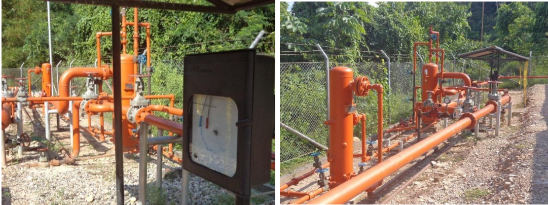
Figura 31. Medidor de gas Tipo Barton del Campo Colorado.
