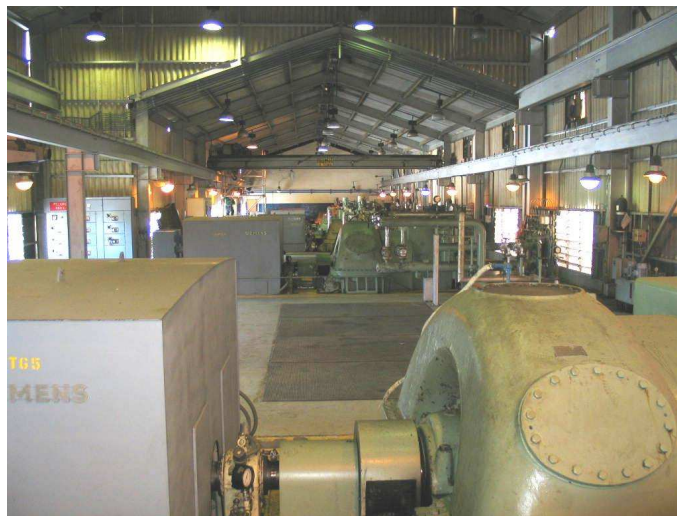
Figura 7. Sala de Turbogeneradores.
