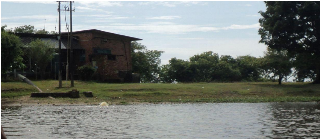
Figura 2. Estación de Bombeo Ciénaga San Silvestre
