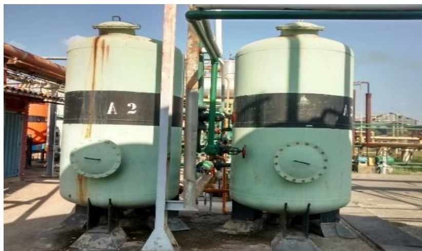
Figura 15. Filtros de Desmineralización A-2, A-3
