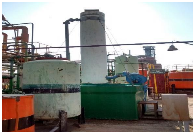
Figura 17. Torre Desgasificadora A-5
