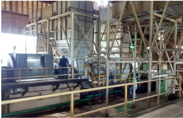
Figura 27. Sistema de Generación de Energía - Turbina TG-1
