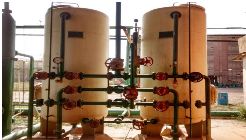
Figura 9. Filtros de Potabilización A-2, A-3
