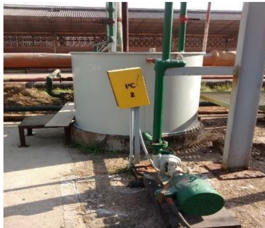
Figura 12. Tanque de almacenamiento agua clarificada SR-8
