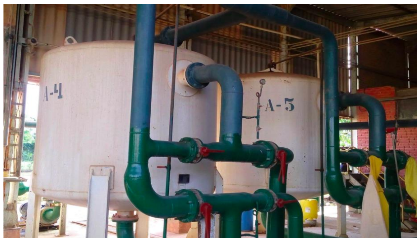
Figura 8. Filtros de Clarificación A-4, A-5
