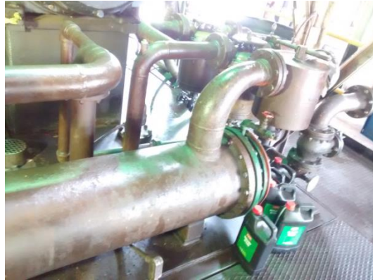
Figura 25. Sistema de Lubricación – Bomba Principal
