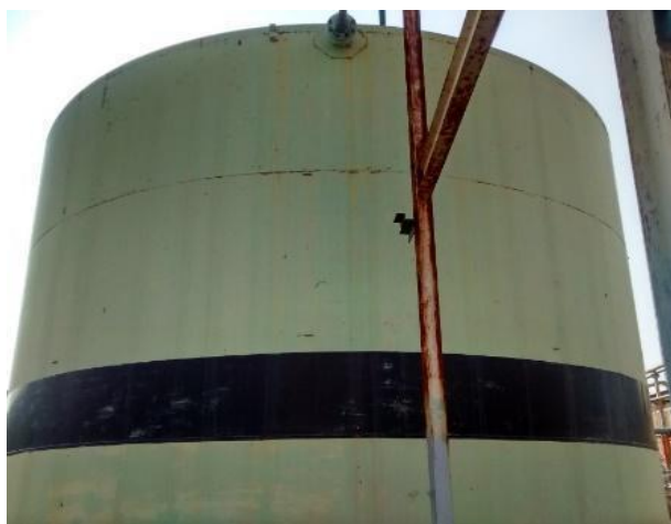
Figura 14. Tanque de almacenamiento agua suavizada SR-3
