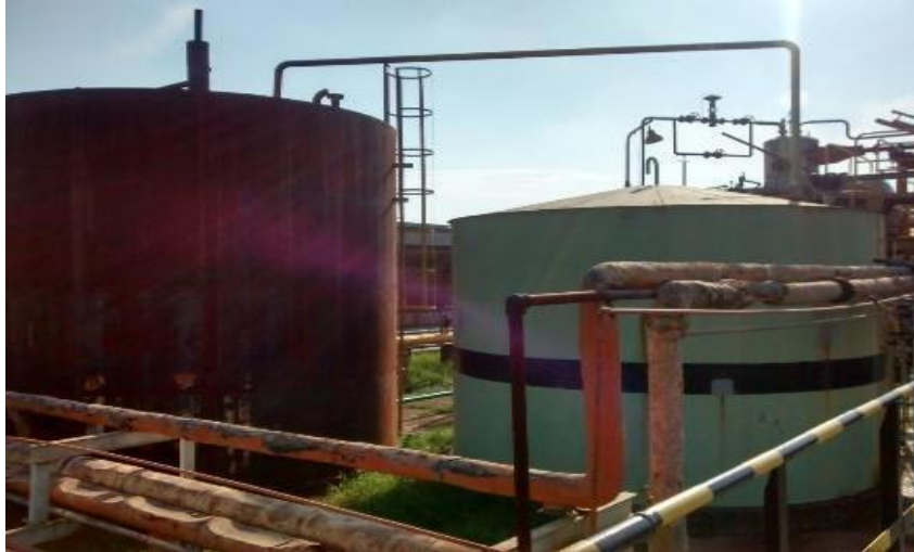
Figura 19. Tanques de Almacenamiento SR-1, SR-2
