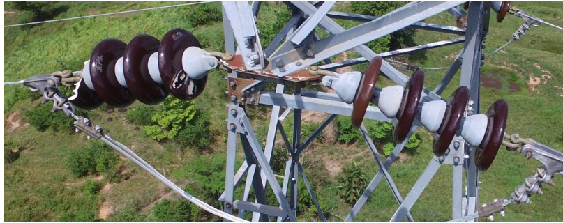
Figura 2.17: Falla en aislador.
