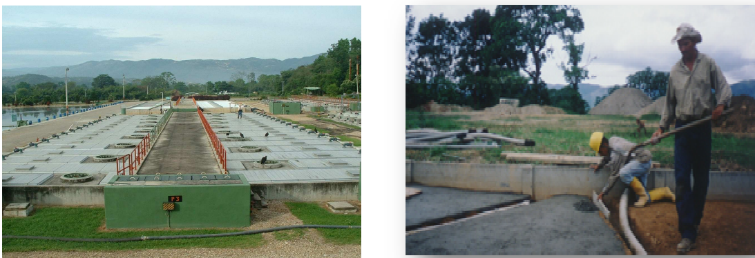
Figura 1 PTAR de Rio Frio- UASB
