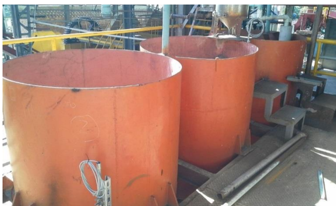
Figura 11. Tanques de prelimpieza.
