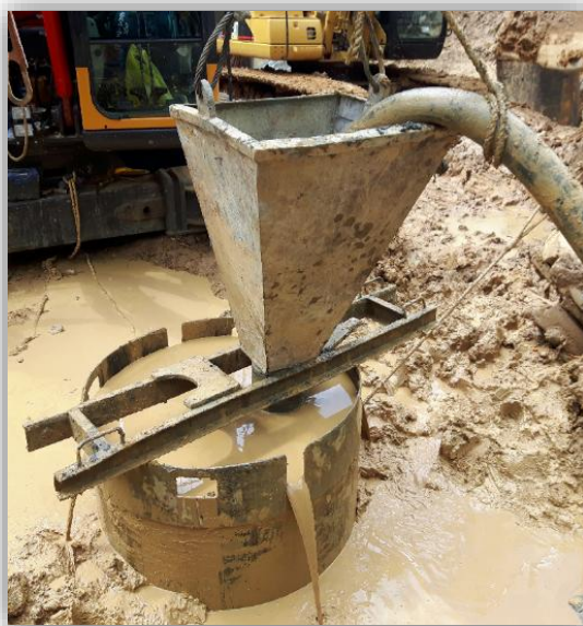
Figura 19. Lodo que emerge por la superficie de la perforación
