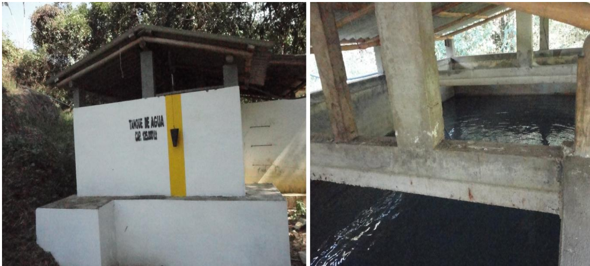
Figura 13. Tanque de almacenamiento de agua, capacidad de 125 m 3
