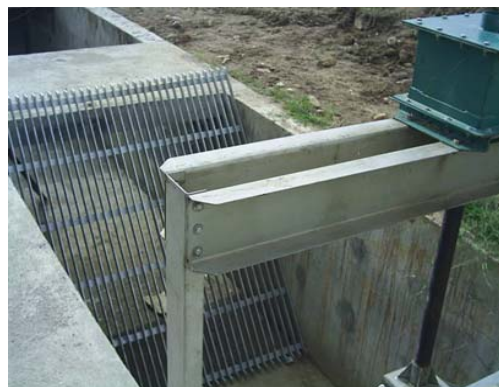
Compuertas y rejillas
