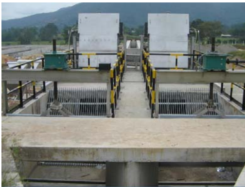
Sub unidad de cribado
