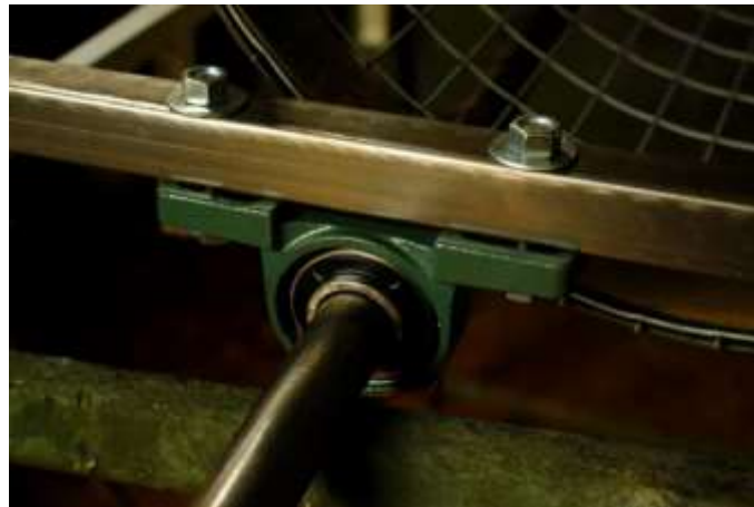
Figura 68. Vista del eje y chumacera atornillada a la estructura.
