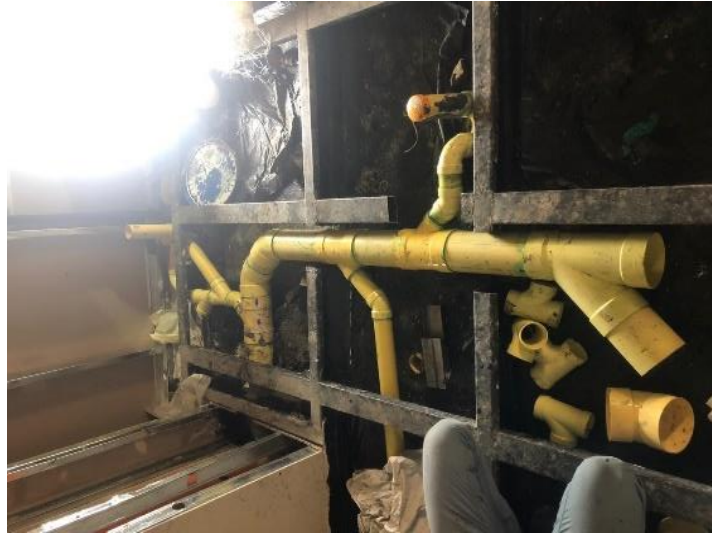
Figura 13. Tubería de desagüe
