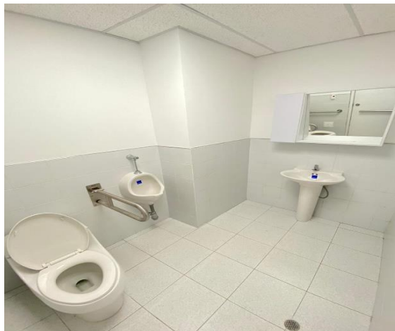
Figura 19. Instalación sanitaria, orinal y lavamanos
