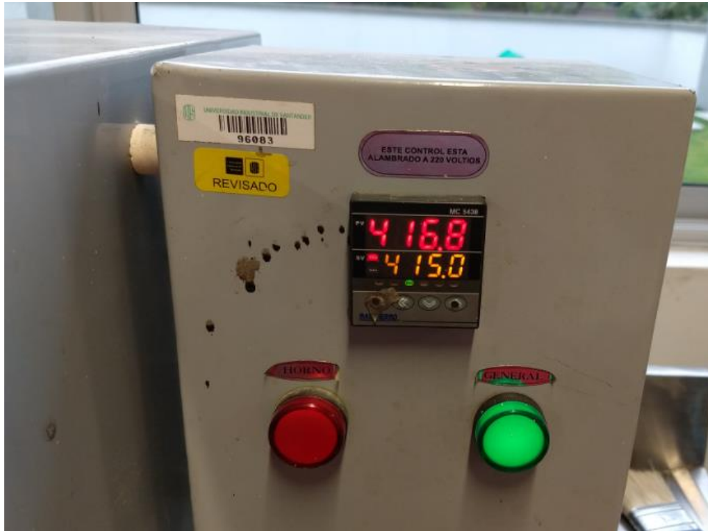
FIGURA 64. Temperatura mostrada por el display de la mufla.
