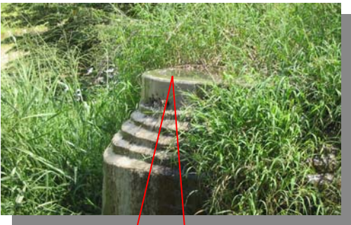
Pozo totalmente rebosado
