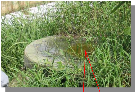
Pozo totalmente rebosado
