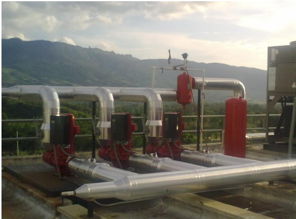
Figura 46. Bombas de recirculación de agua marca Armstrong.
