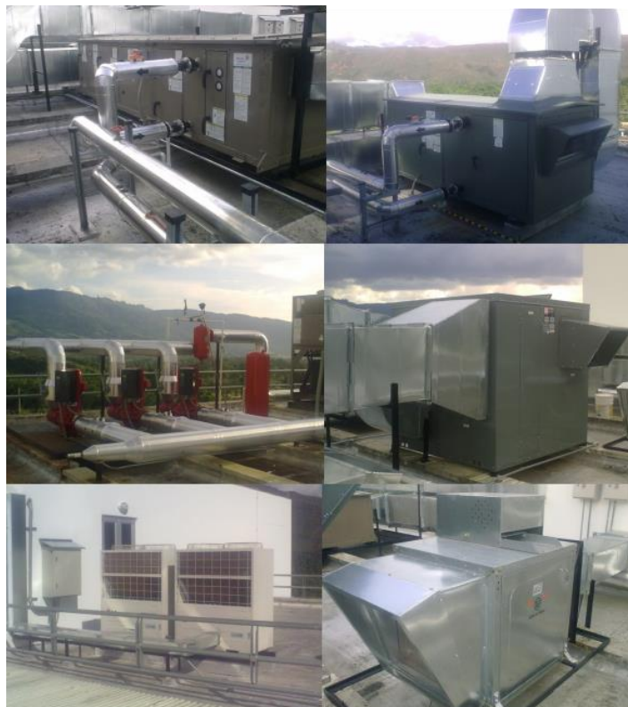
Figura 2. Sistema de aire acondicionado.
