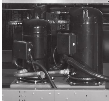
Figura 40. Compresor sistema de enfriador ENF-01/02.
