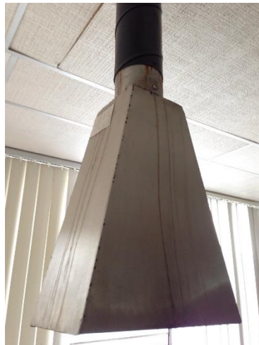
Figura 20. Sistema De Extracción De Gases Para Absorción Atómica.
