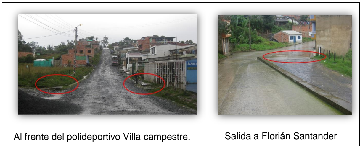
Figura 23: Errores constructivos en las estructuras de evacuación de las aguas lluvias.
