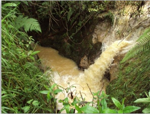
Punto de descarga de las aguas lluvias captadas en los sumideros de fondo ubicados en la carrera 3 al frente del parque central
