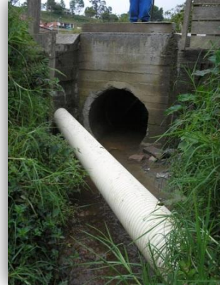
Cruce de la tubería Quebrada El Colegio, vía La ESE aguas abajo.
