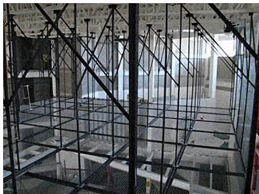
Figura 3 Parrillas de tramoya
