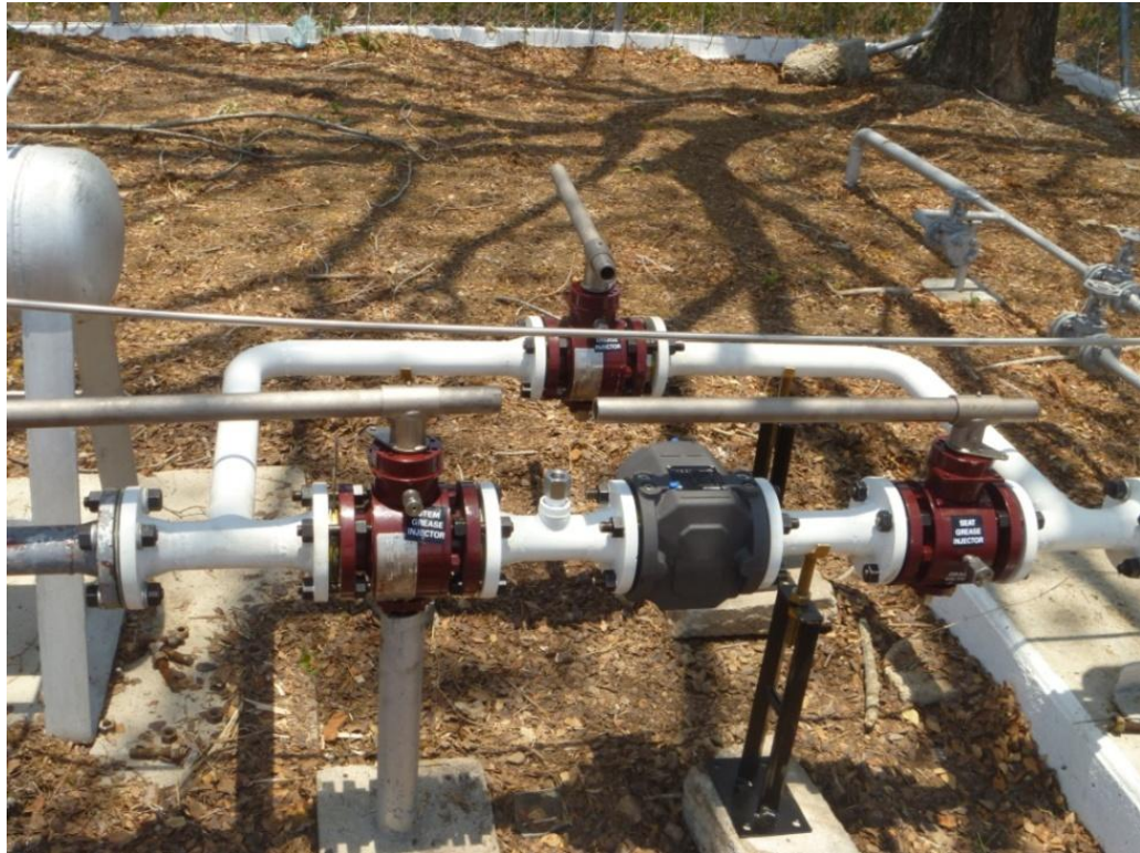
Figura 4. Estación de medición y regulación.
