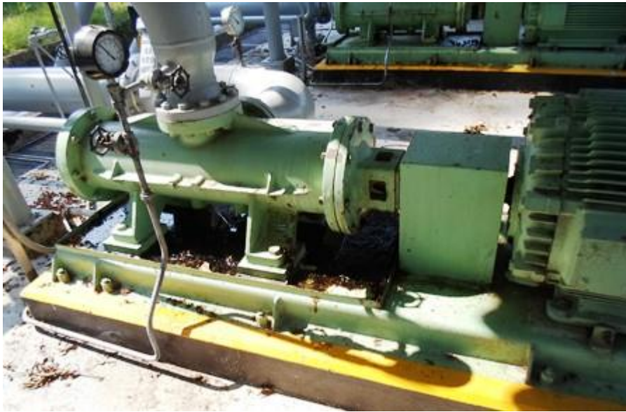
Foto 10. Bomba de despacho de crudo
