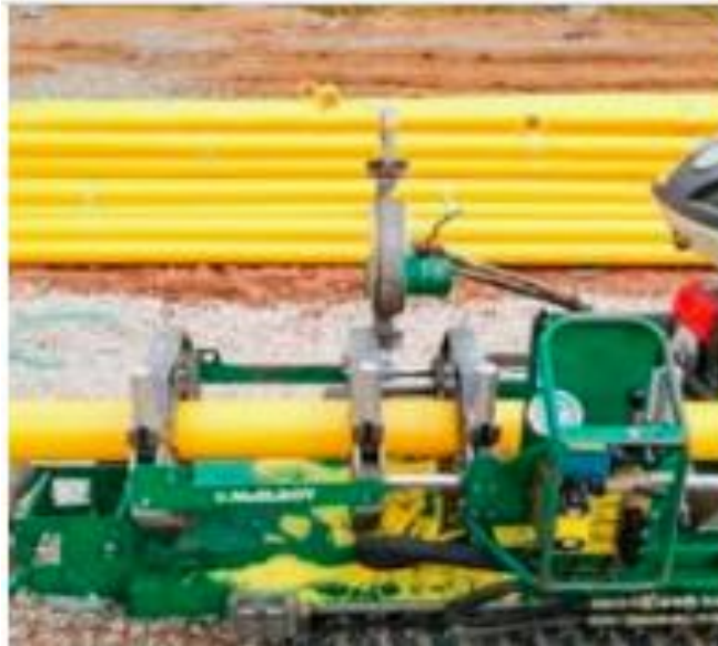
Figura 3. Instalaciones de gas usando tuberías fabricadas en Poliamida (PA).
