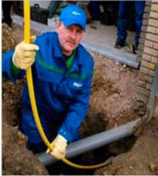
Figura 2. Instalaciones de gas usando tuberías fabricadas en Polietileno (PE).
