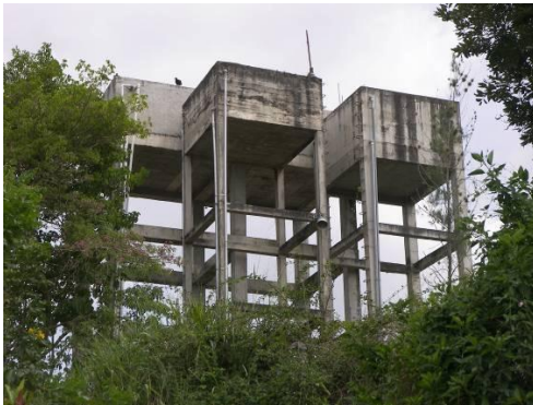
Figura 7. Tanques de almacenamiento elevado
