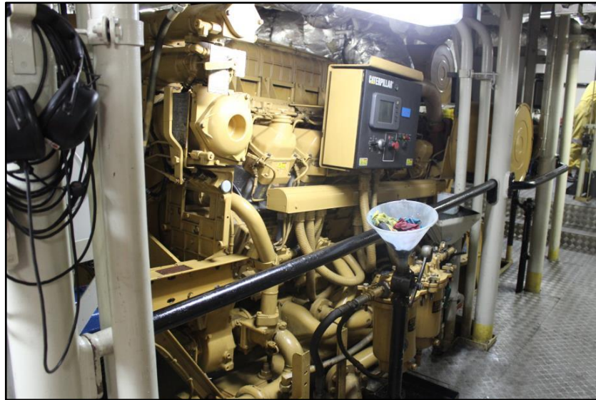
Figura 18. 9004-P-MOT-0101 Motor Propulsor
