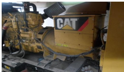
Figura 44. Planta de Emergencia Caterpillar
