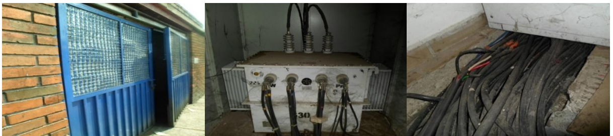
Figura 43. Entrada al cuarto de alta potencia, Transformador de 13Kv a 225Kv, cableado
