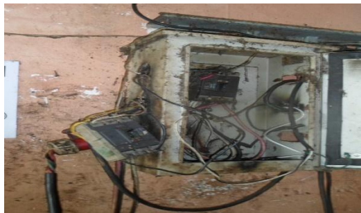
Figura 47. Caja de distribución
