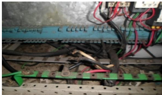
Figura 45. Cableado de tablero de control
