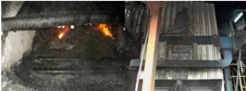
Figura 49. Hogar caldera 1, Hogar caldera 2
