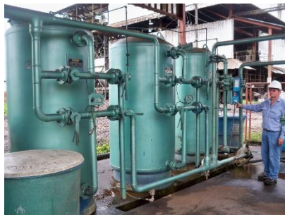
Figura 23. Equipos de suavización de agua
