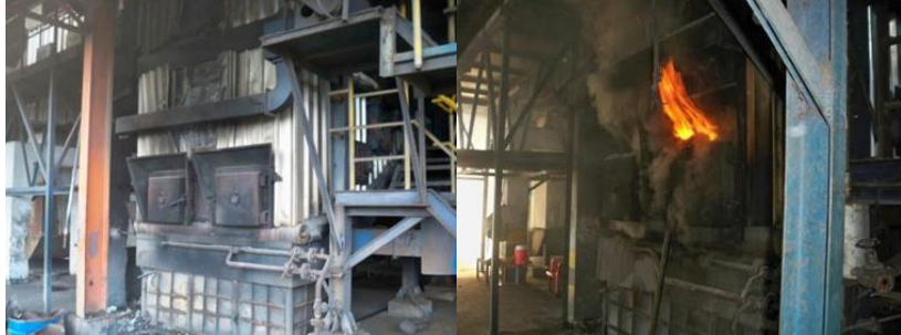
Figura 48. Compuertas de la caldera 2, compuertas de la caldera 1
