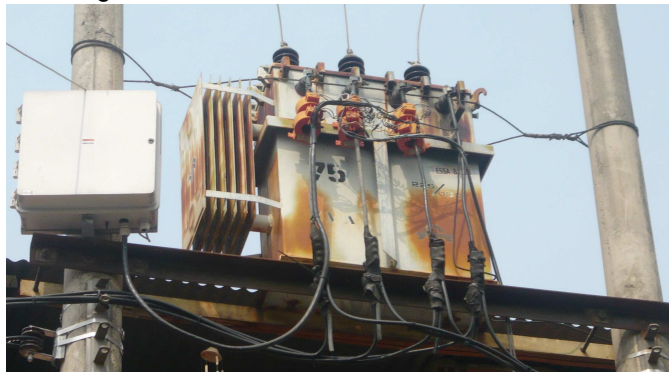
Figura 12: Transformador de distribución 4148
