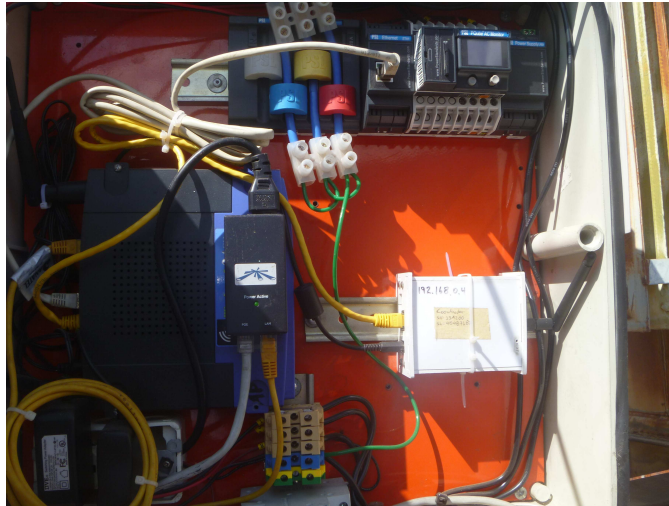
Figura 8: Analizador de red PQube instalado en el transformador
