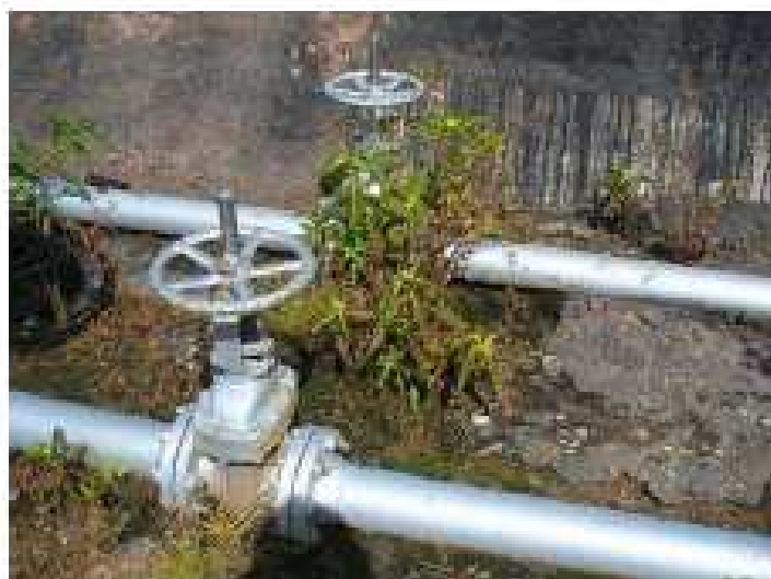
Foto 4. Válvulas y tuberías apoyadas en el suelo. Se evidencia daño en la pintura de las tuberías
