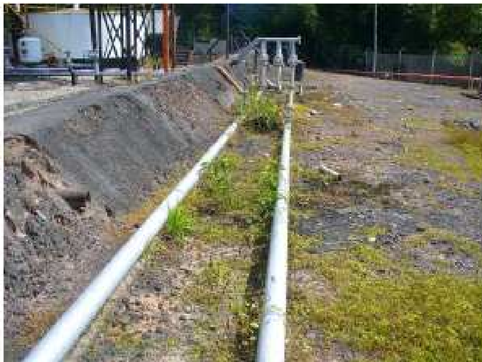
Foto 3. Tuberías a desenterrar
