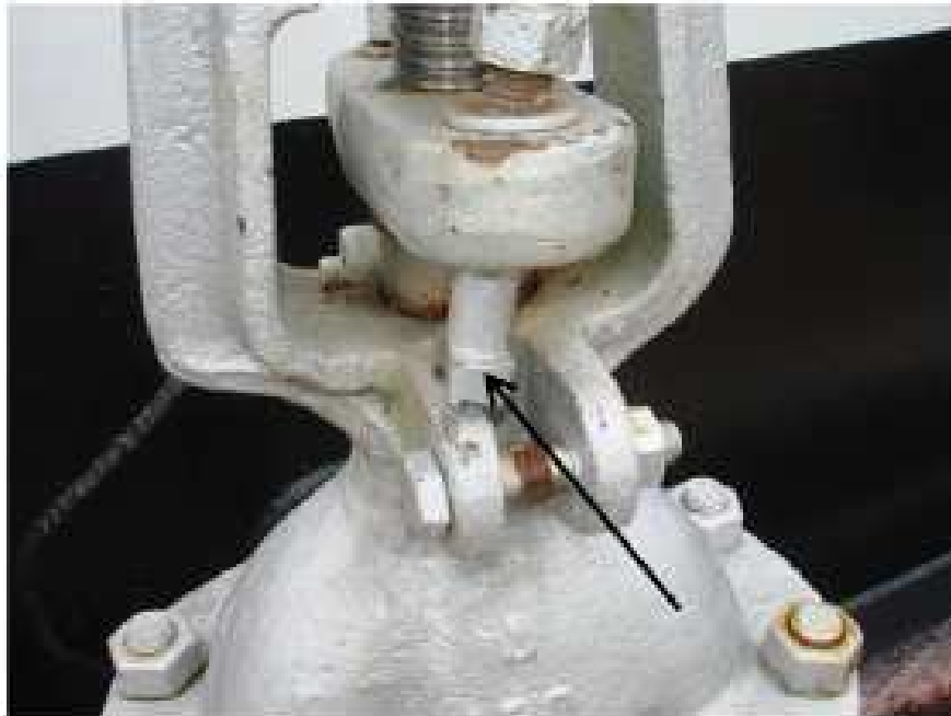
Foto 5. Válvula de recibo Tanque 01. Fractura en el Perno de ojal de retención del prensaestopa.
