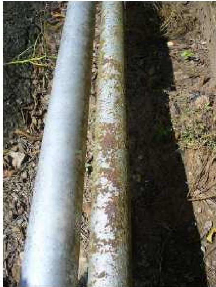
Foto 1. Corrosión en tuberías de entrada estación de recolección
