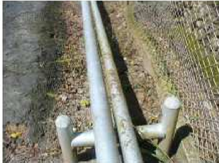
Foto 2. Corrosión en tuberías. En algunos puntos no hay separación entre las líneas.
