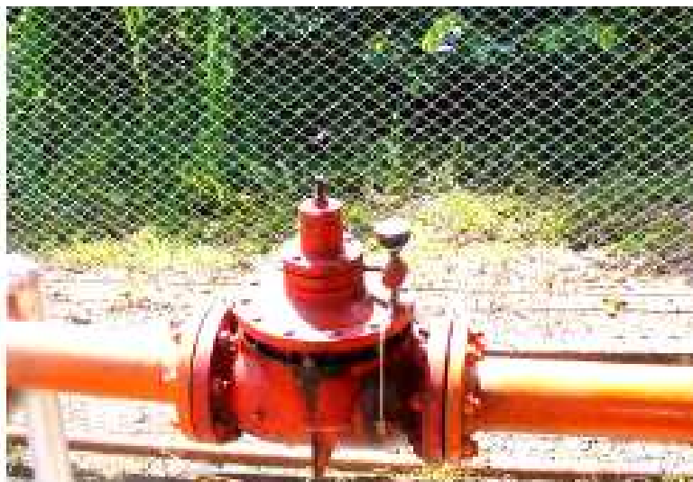
Foto 6. Válvula de retención línea de gas presenta fugas.
