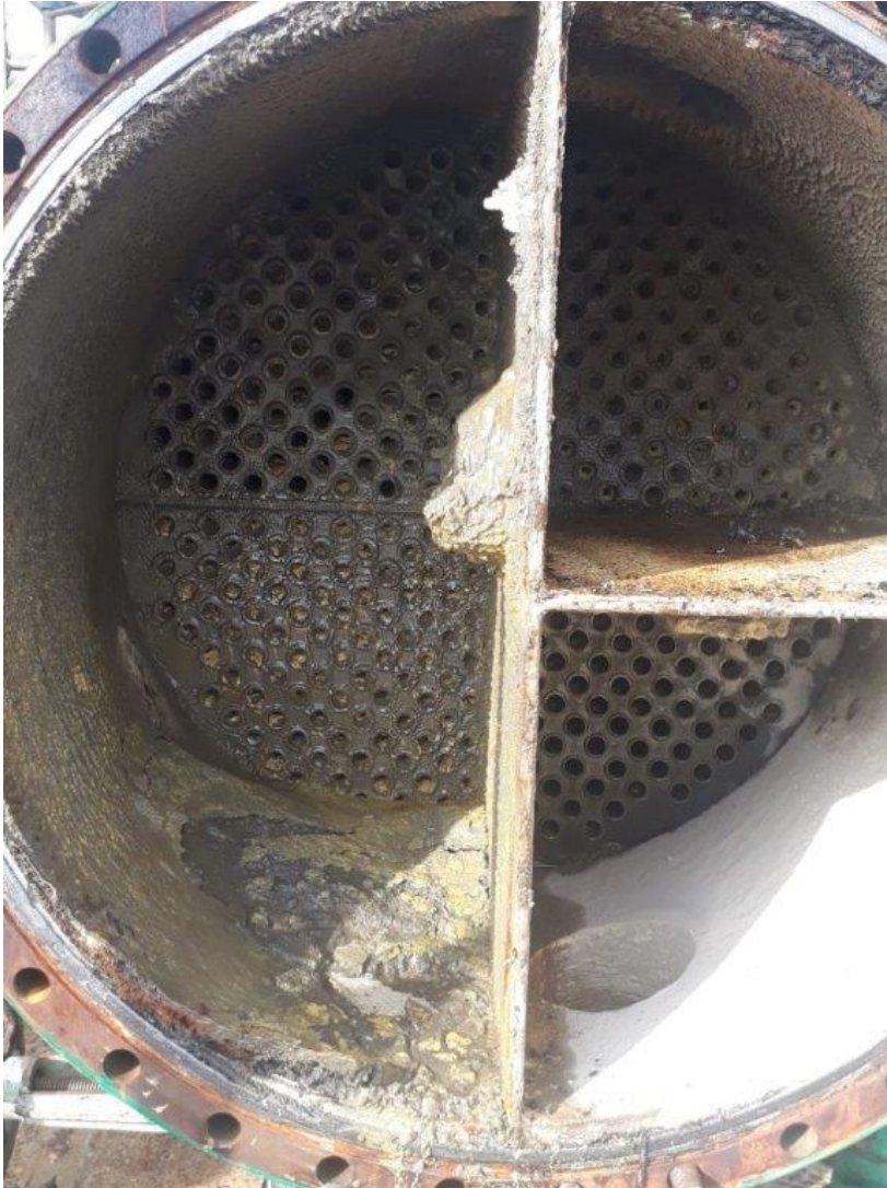
Figura D.3. Haz de tubos del E-1160 en el año 2018
