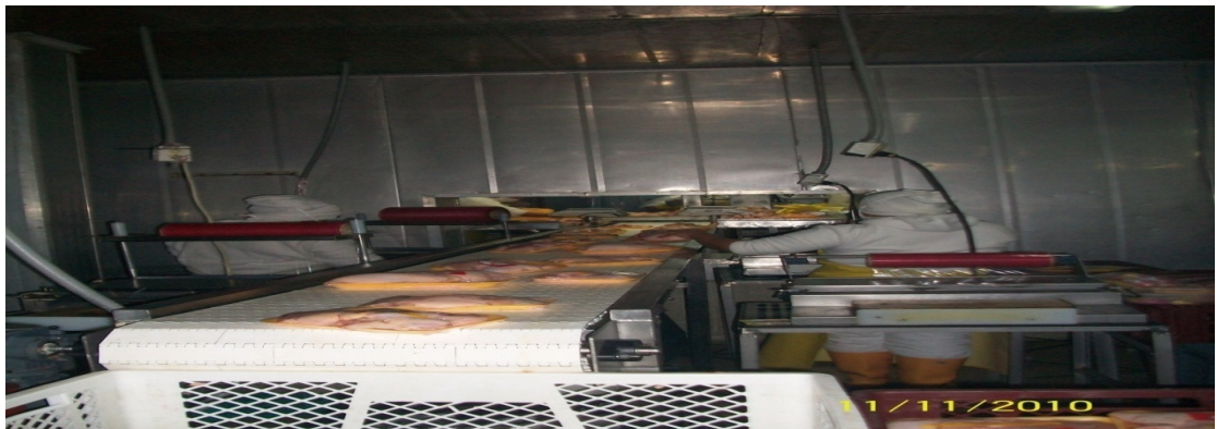
Foto 31. Nueva banda transportadora
