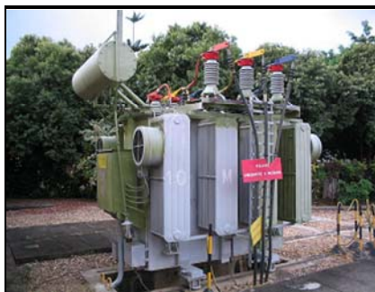
Figura 4. Transformadores de la subestación Minas
