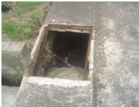
Figura 21. Deterioro marco de la tapa del filtro
