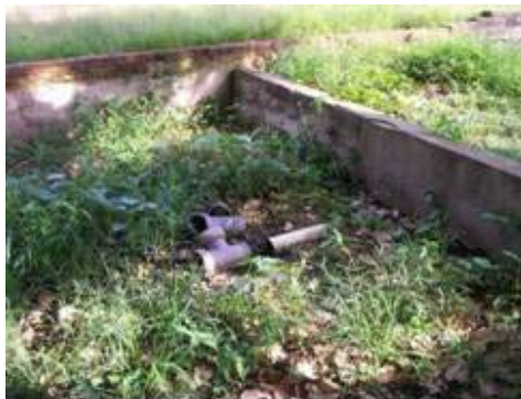
Figura 25. Filtro goteador sin mantenimiento
