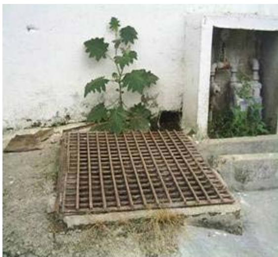
Figura 10. Trampa de grasa de zona de lavado
