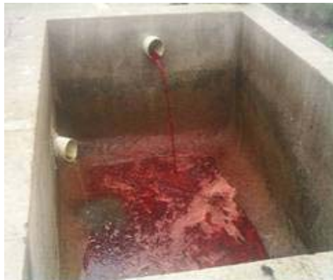
Figura 36. Entrada de efluente a la trampa de grasas
