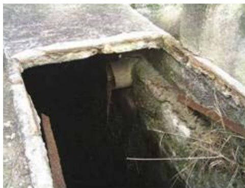
Figura 22. Deterioro marco de la tapa del filtro
