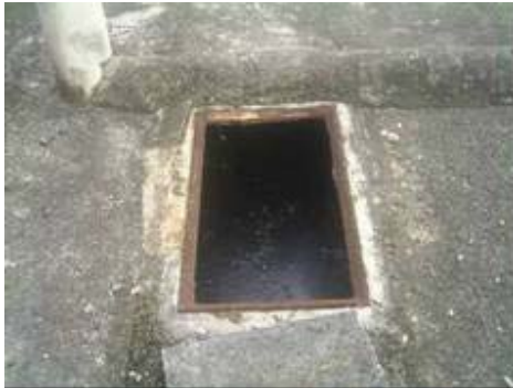
Figura 19. Colmatacion filtro anaerobio
