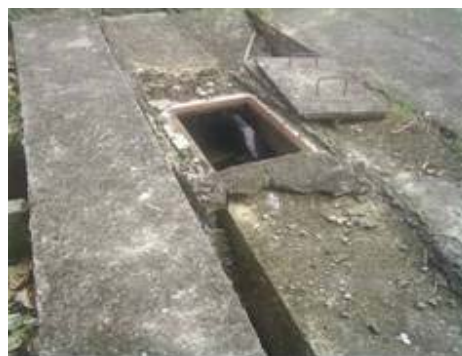
Figura 18. Daño placa o cubierta
