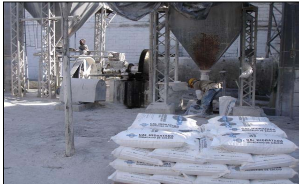
Fotografía 9 Sección de molienda de cal hidratada
