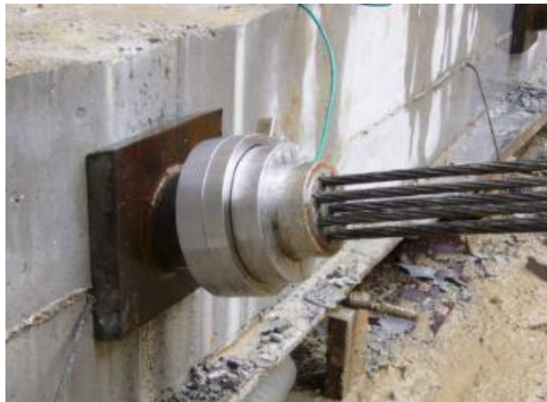
Celda de carga instalada.
