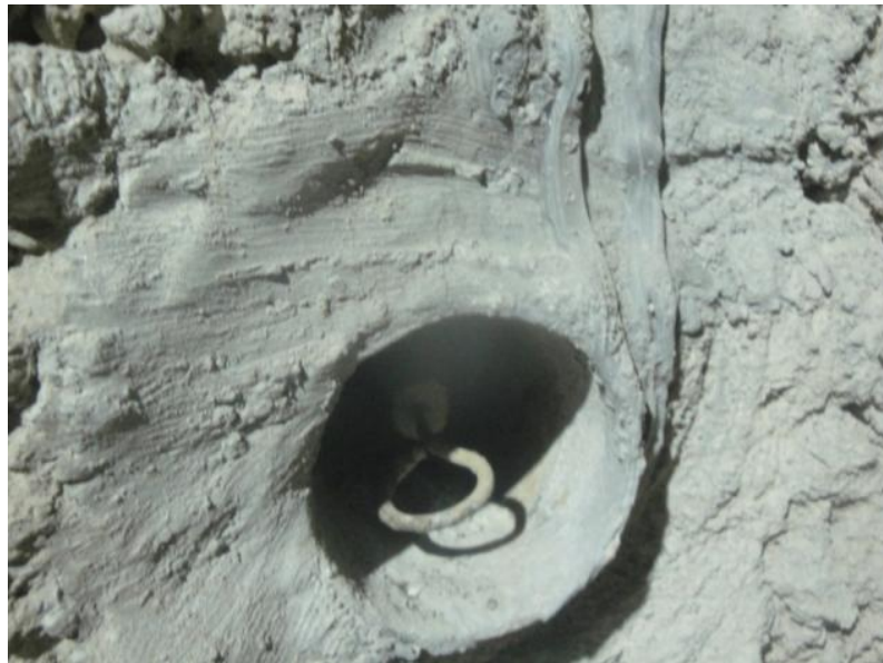
Aspecto de Argolla de convergencia instalada.
