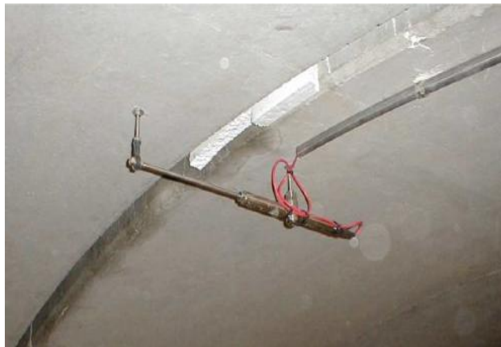
Medidor de juntas instalado.
