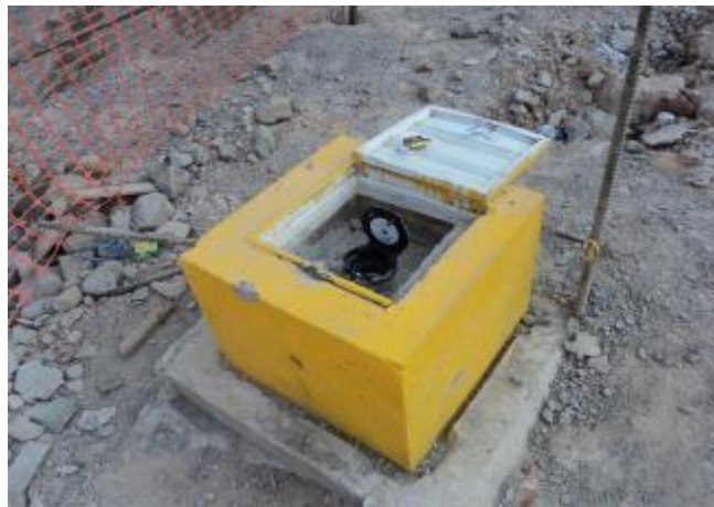
Caja de protección en concreto.
