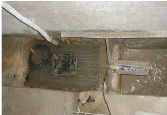
Vertedero de aforo instalado.
