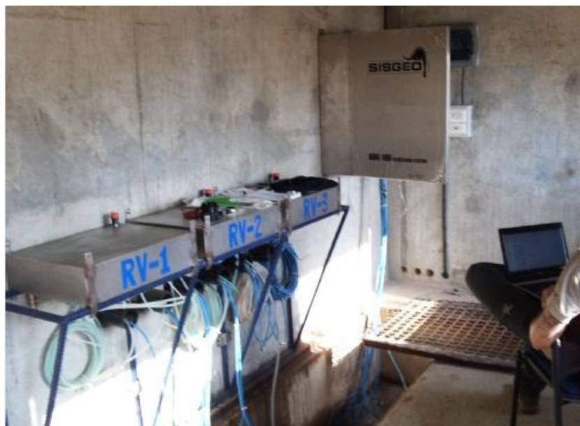
FIGURA 17. Interior de la caseta de instrumentación CS-4.
