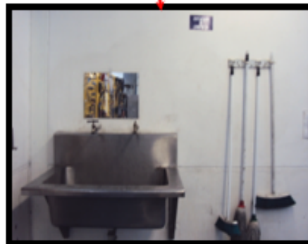
ESTACIÓN DE LIMPIEZA
