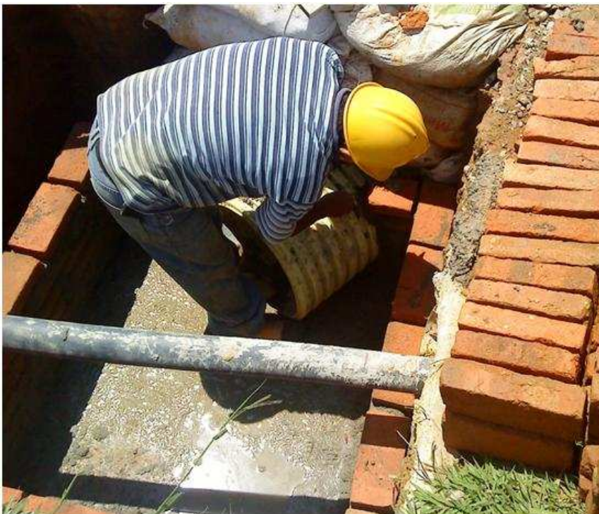
Figura 9, Caja de inspección
