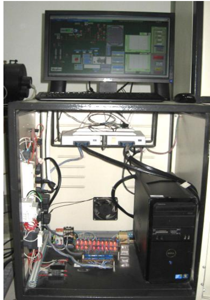
Figura 7. Sistema de control y adquisición de datos del E.D.R
