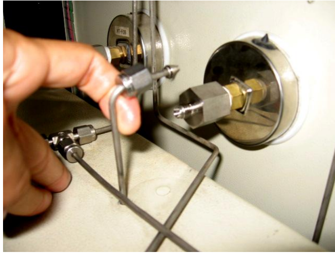
Figura 61. Fuga por conexión en el manómetro de entrada
