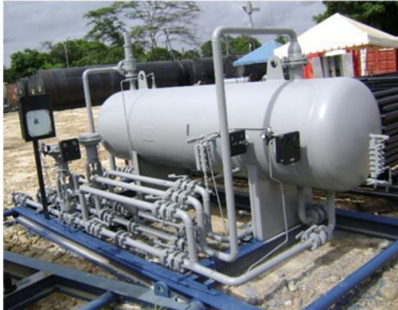
Figura 1. Separador de prueba
