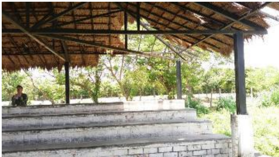
Figura 6. Desprendimiento parcial de la cubierta en las Bahías de Instrucción.
