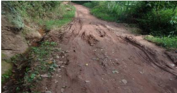
Figura 3. Estado actual de la vía en la Vereda de la Vega.
