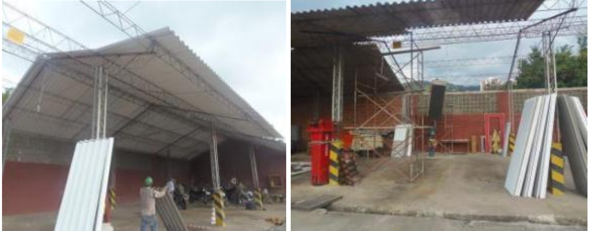
Figura 18. Trabajos en la instalación total de cubierta en la Sección de Transportes.
