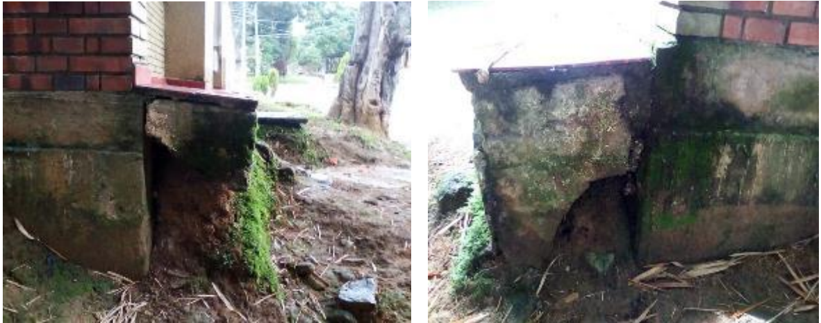
Figura 12. Estado en el cual se encuentra el andén perimetral.
