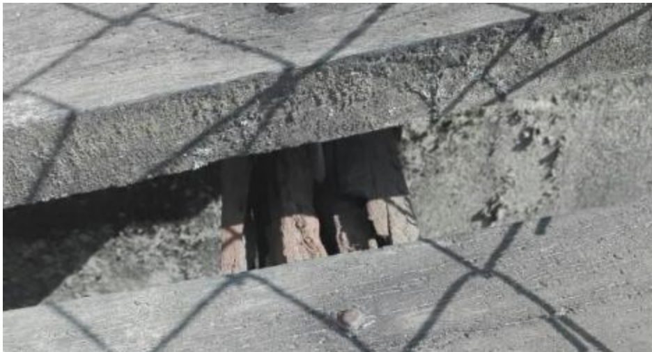
Figura 8. Estado de la madera a consecuencia del óxido.
