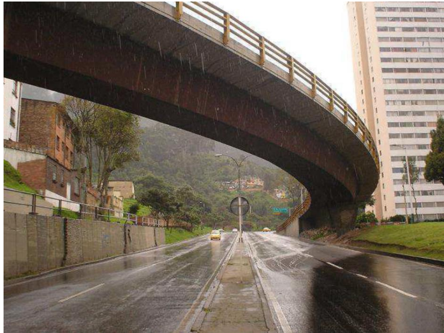
Figura 6. Puente viga cajón en acero con losa en concreto reforzado (puente carrera 5 con calle 26 – Bogotá, Colombia).
