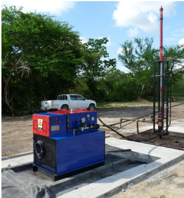
Figura 13. Unidad Mecánico Hidráulica pozo Bonanza 15.
