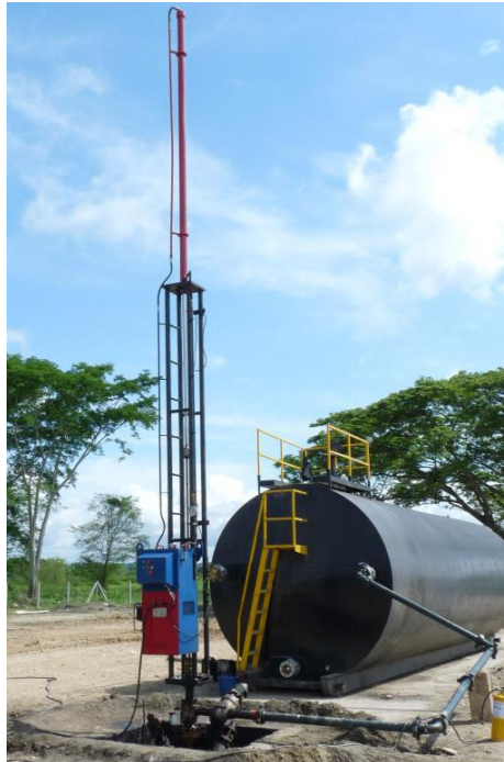
Figura 12. Unidad de Bombeo Hidráulica.
