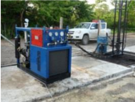
Imagen 2. Unidad hidráulica de bombeo mecánico.
