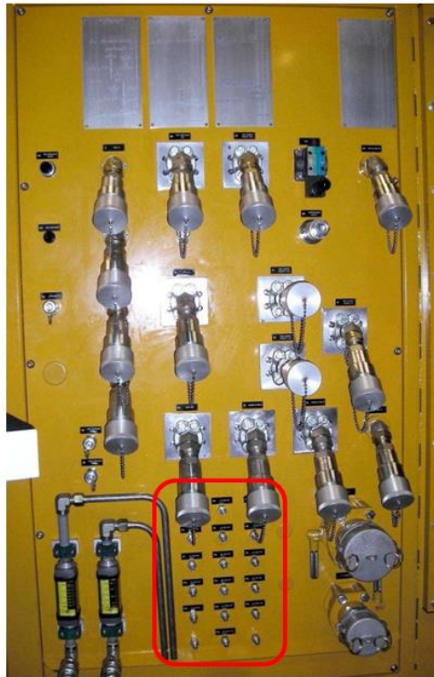
Figura 39. Localización de puertos de toma de presión.
