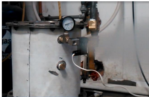
Figura 87. Generación de vapor de la caldera
