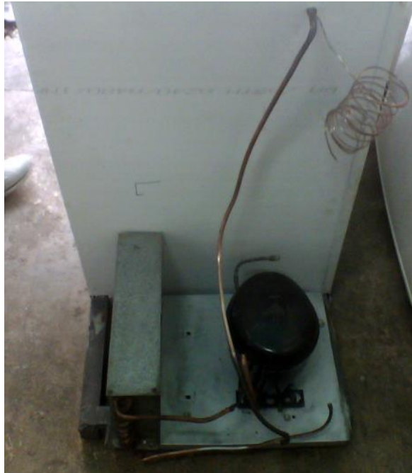
Figura 69. Unidad de refrigeración
