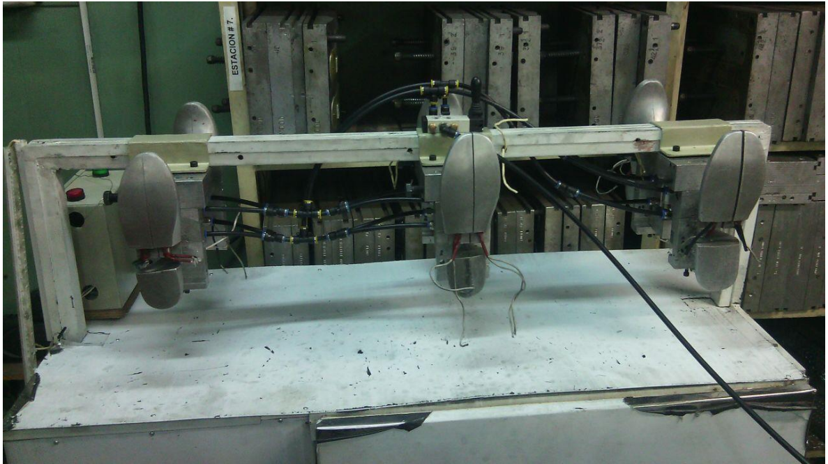
Figura 83. Sistema eléctrico completo
