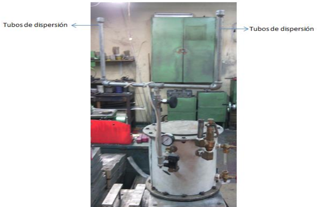
Figura 65. Tubería de dispersión
