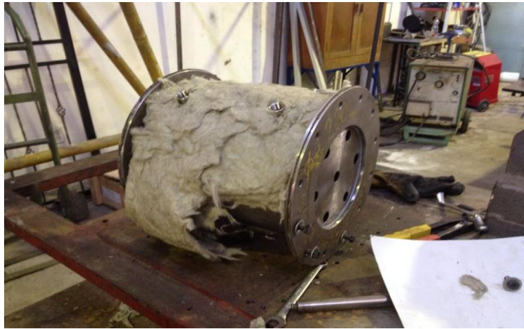
Figura 62. Caldera recubierta con lana mineral
