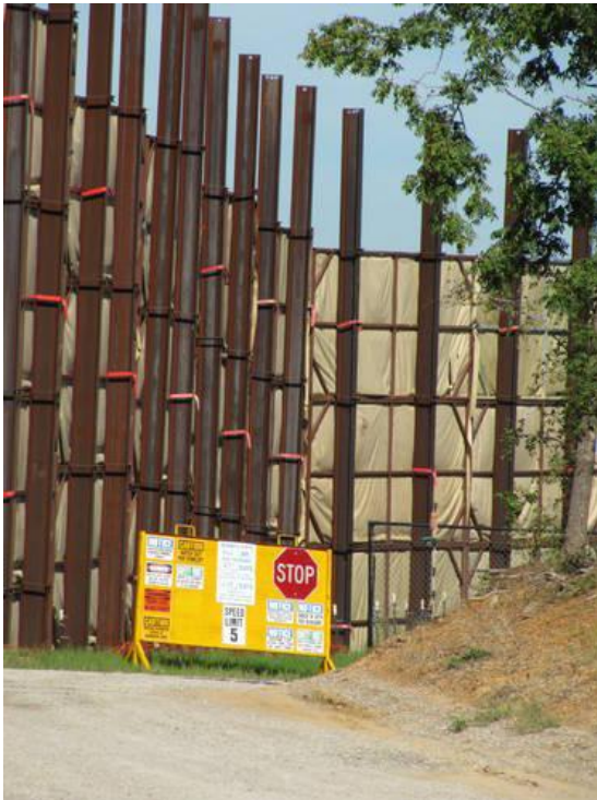
Figura 8. Muro temporal para mitigar el ruido de las operaciones de shale gas
