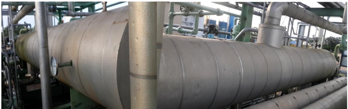
Gráfica 13. Chiller (Intercambiador).
