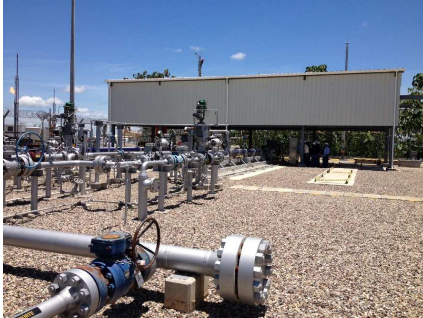
Figura 2. Facilidades para bombeo de agua a pozos inyectoros.
