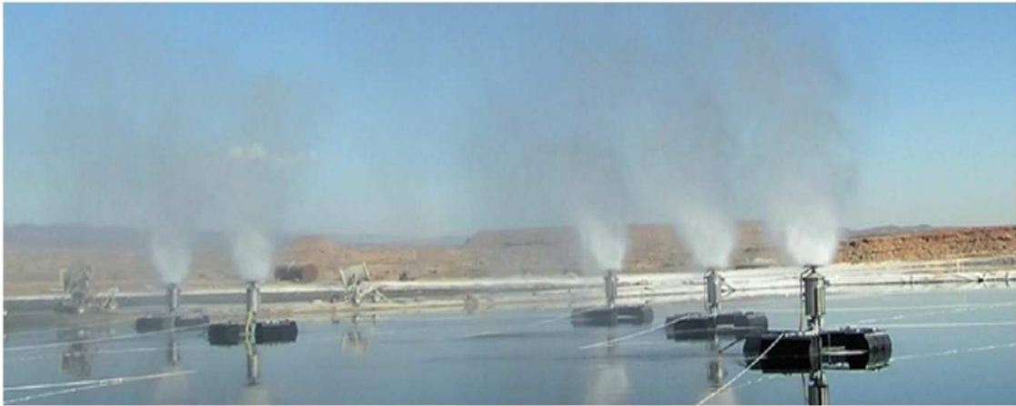
Figura 12. Vista de evaporadores mecánicos en funcionamiento.
